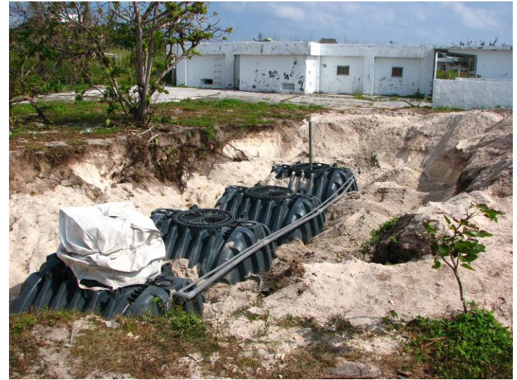
設置雨水收集設施
